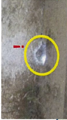
壁や床の破損がないか(外の 光が漏れている所は要注意)
