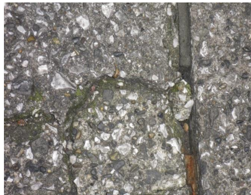
床のひび割れにも食中毒菌や昆虫がひそんでいることがあります。
