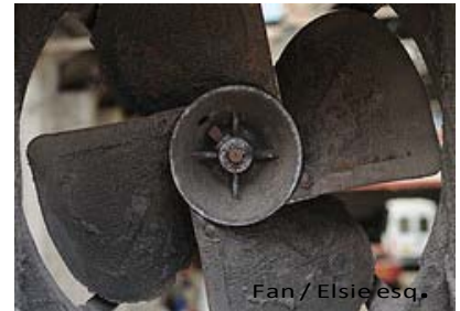
換気扇の汚れにも注意！
